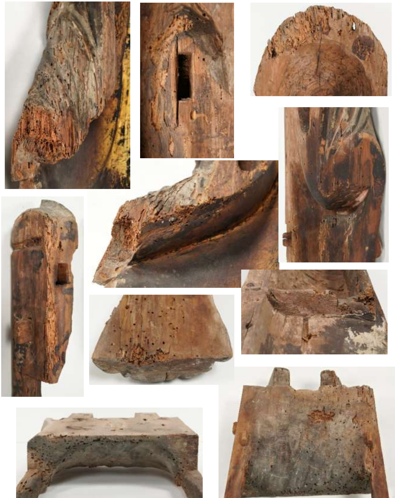
矧面及び軀内等に見られた虫蝕朽損状況
