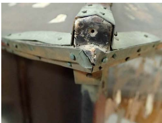
2 5. 屋蓋の鋸金具が折れ曲がった状態
