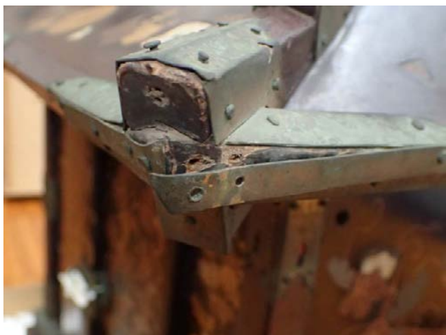
29. 修理前 屋蓋 金具の鉋が欠失した状態
