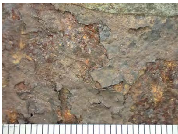
20 漆塗膜の状況 2
