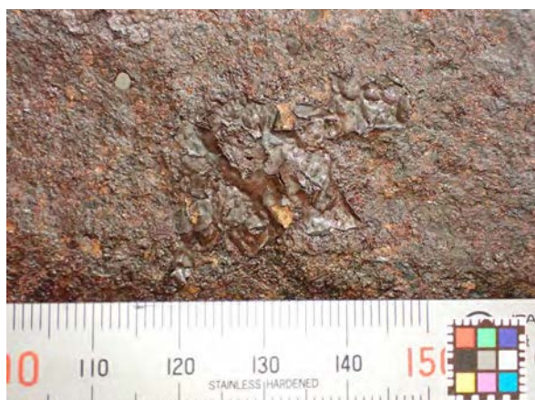
19 漆塗膜の状況 1
