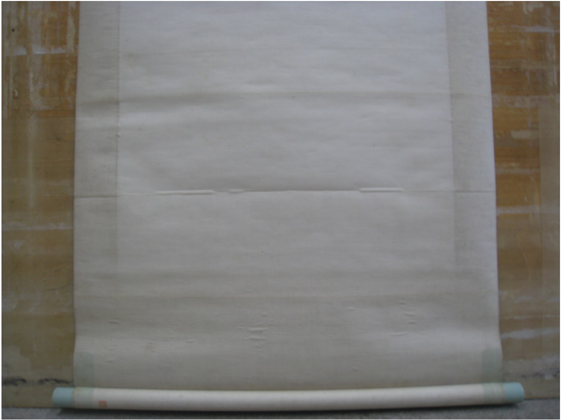
糊浮きが多数見られる
